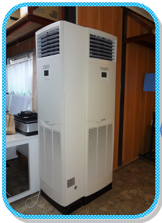
1階に設置してあるクーラー
